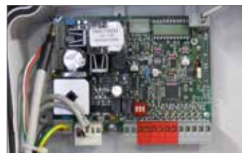
Armoire de commande CT10224
